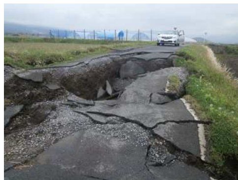
通行不能となった農道
