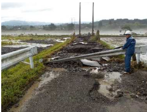
被災した農業用道路
