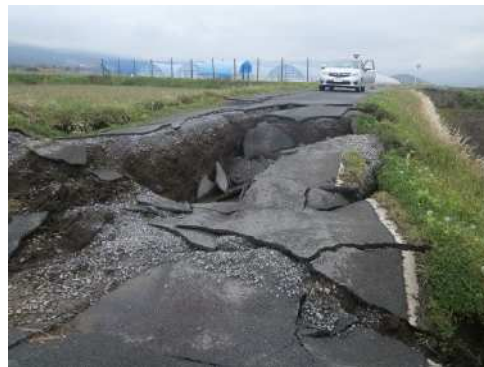
通行不能となった農道
