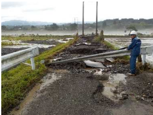
被災した農業用道路
