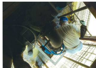
( 揚水ポンプ点検 )
